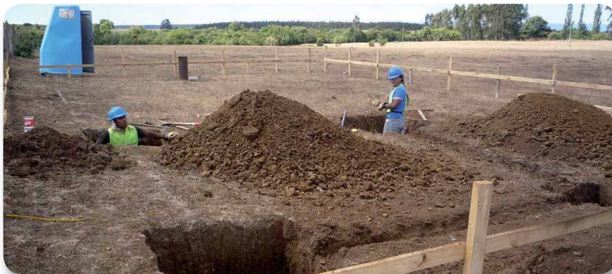
Instalación del Servicio de Agua Potable Rural Trihueche. Nueva Imperial, Región de La Araucanía.
