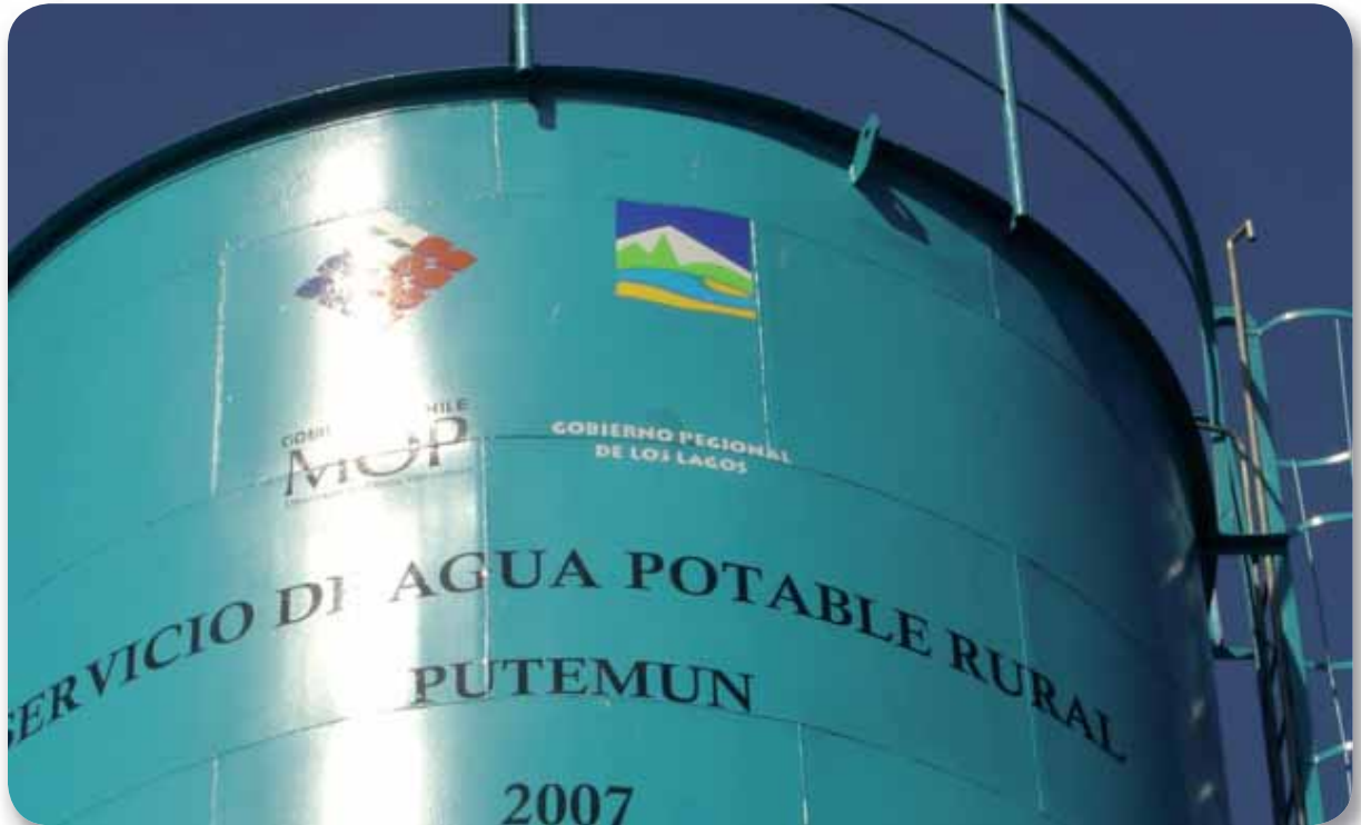
Instalación del Servicio de Agua Potable Rural Putemun. Castro, Región de Los Lagos.
