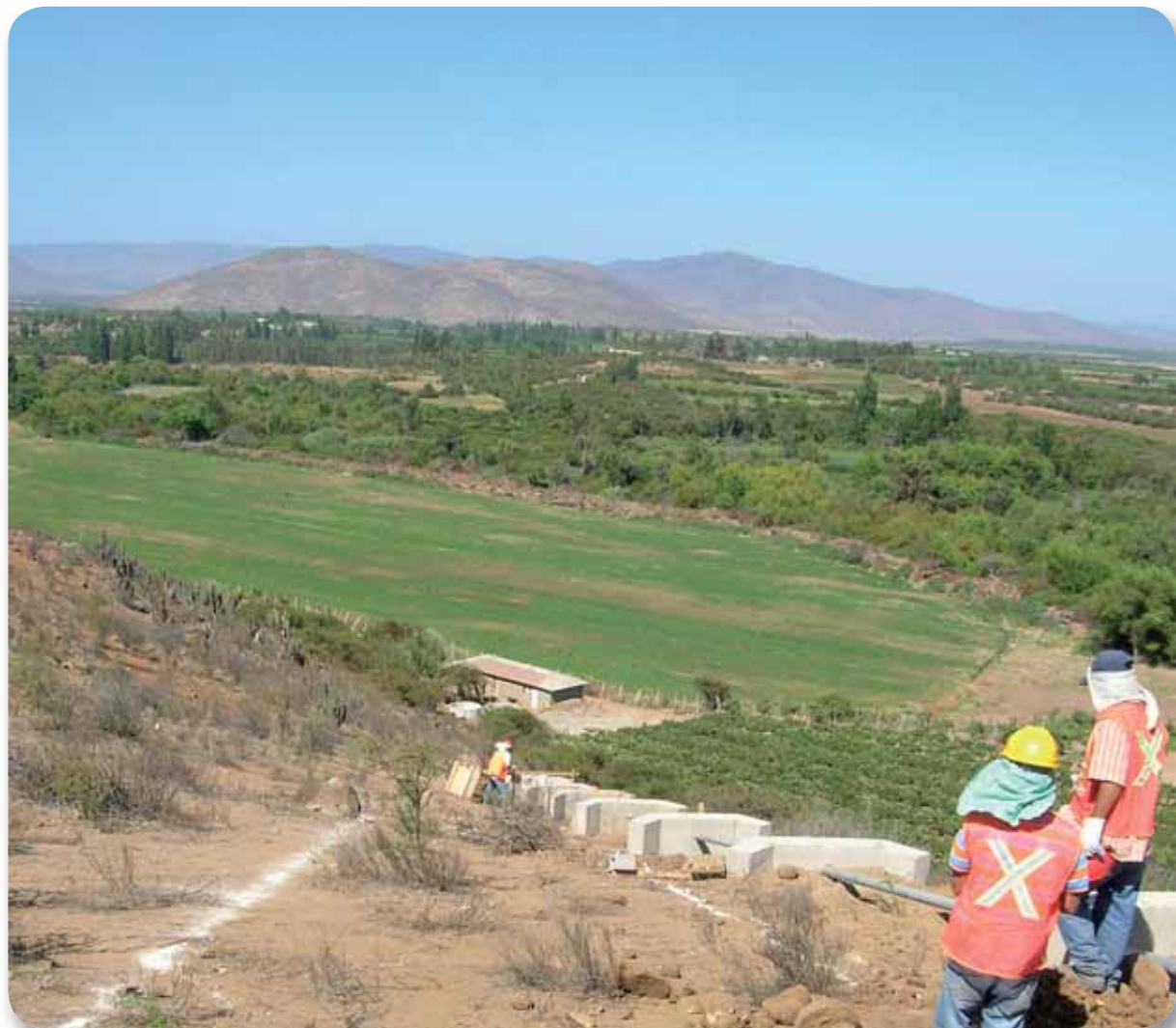
Instalación Sistema de Agua Potable Rural de Oruro Alto. Ovalle, Región de Coquimbo.
