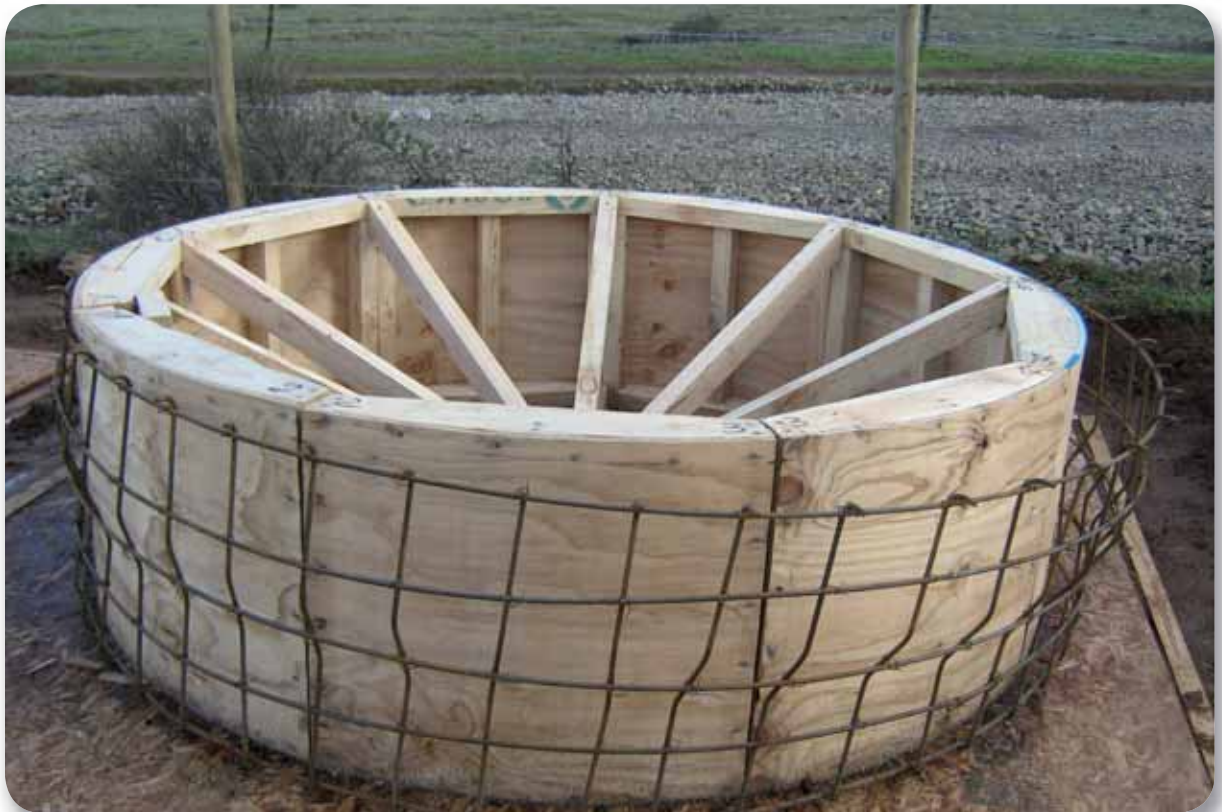
Agua Potable Rural, Maica, Región de la Araucanía.
