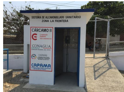
Fotografía 4: Sistema de alcantarillado de la zona de La Frontera (cárcamo de bombeo de aguas residuales).
