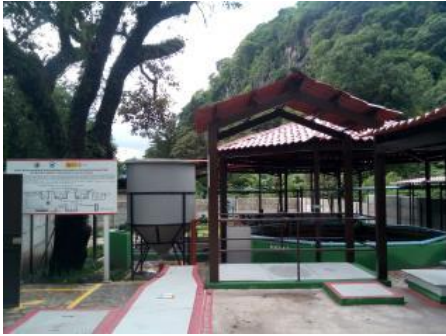
Fotografía 1: Planta de Tratamiento de Aguas Residuales de Tipo Reactores Secuenciales SBR, Barrio 2, San Marcos La Laguna, Sololá
