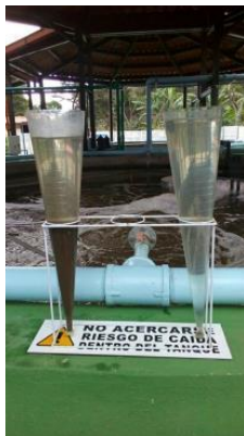
Fotografía 3: Monitoreo a proceso de depuración, Planta de Tratamiento de Aguas Residuales de Tipo Reactores Secuenciales SBR, Barrio 2, San Marcos La Laguna, Sololá.
