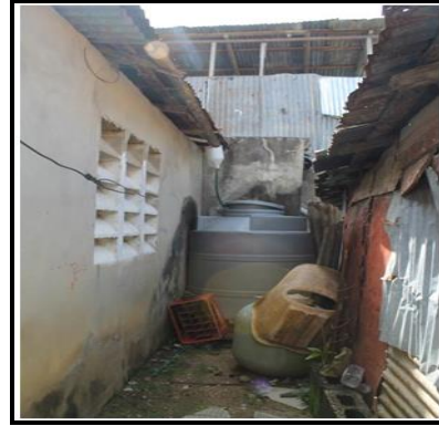
Sistema actual de abastecimiento de agua por lluvia - Cancino Adentro, SDE - 11-2015
